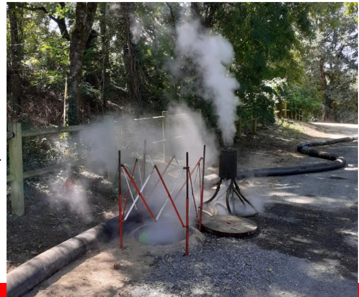
Evacuation de la vapeur
